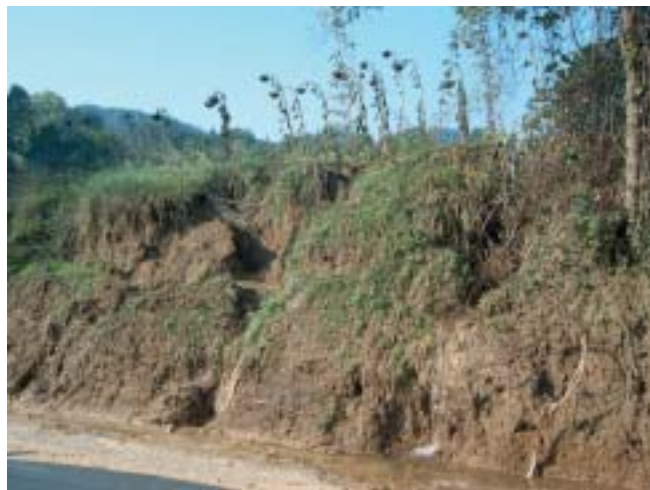
Erosione e smottamenti sulla sede stradale causati dalla coltivazione di piante annuali fino a bordo strada
